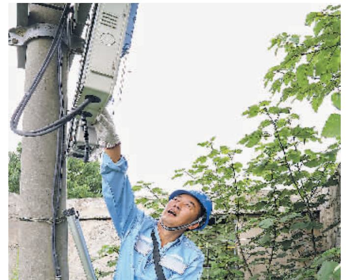
电力人员检查武镇天鹅村铁厂组公变计量装置。
