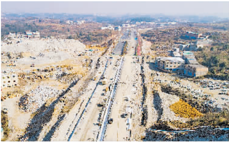
松柏环线北段(贵安段)项目主体工程基本完工,正推进附属工程建设。
