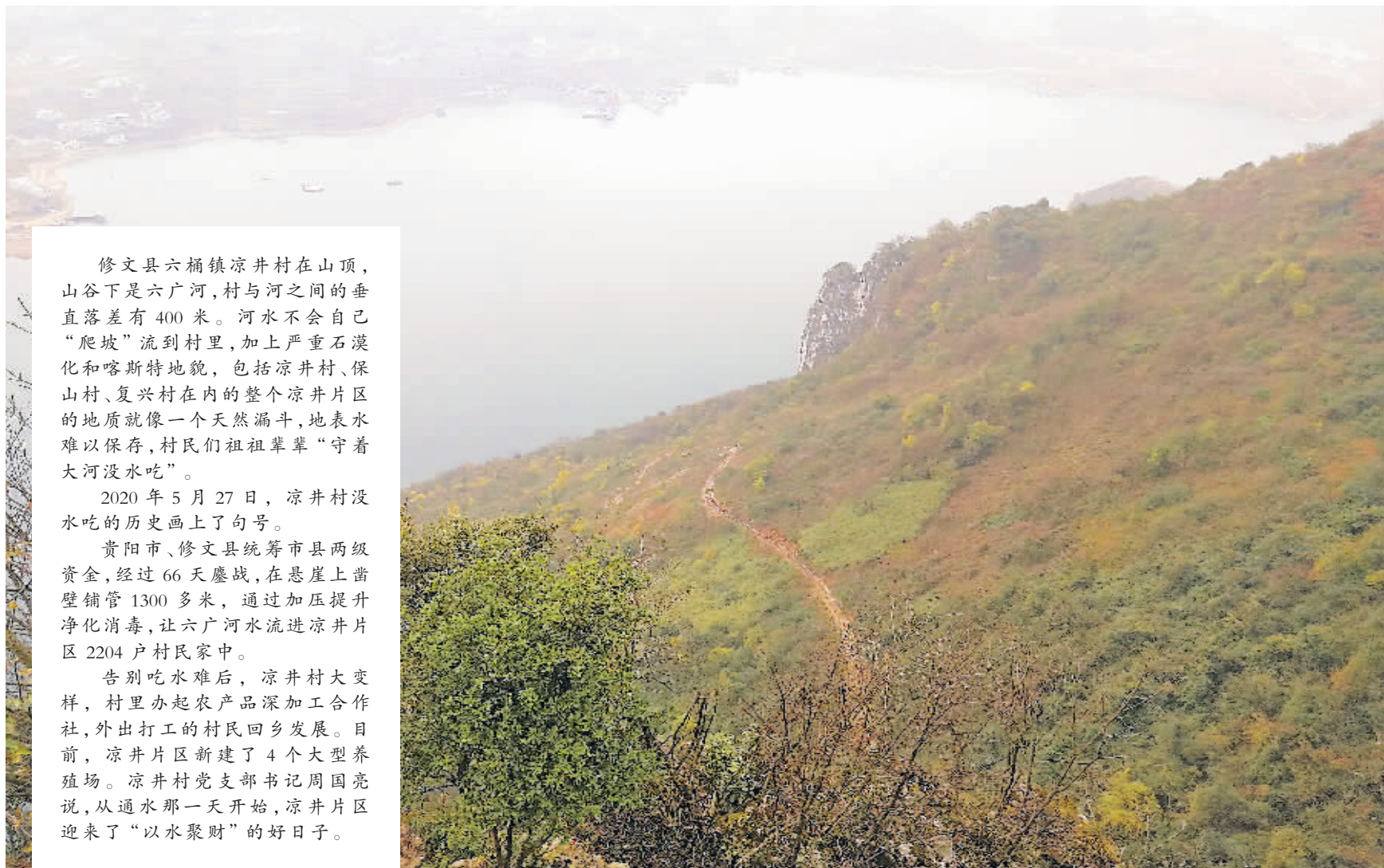
悬崖上凿壁铺设的引水管道。
