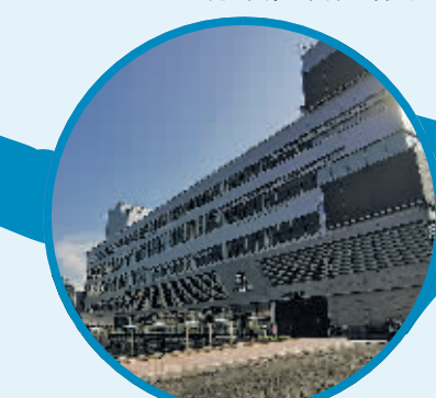
正在建设中的通源汽车文化广场项目。观山湖区发改局供图
