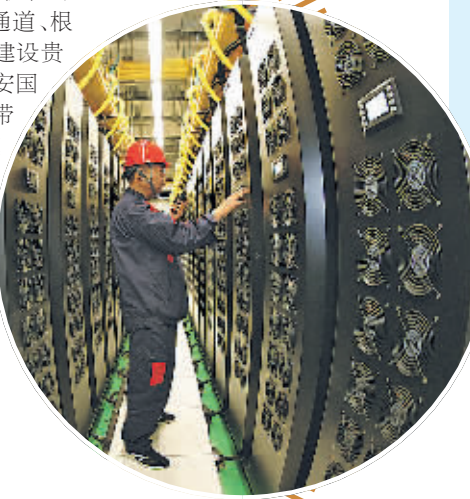
▲ 技术人员在贵安超算中心数据机房内巡检。
