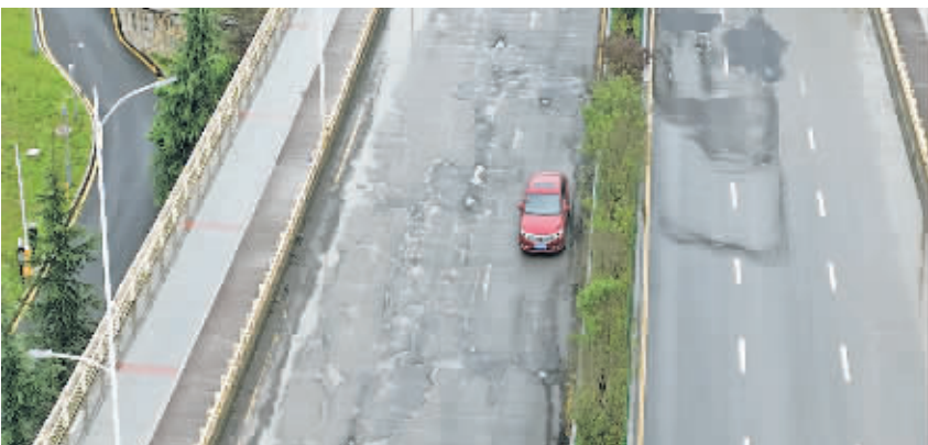
清镇市龙凤大桥桥面坑洼破损。
