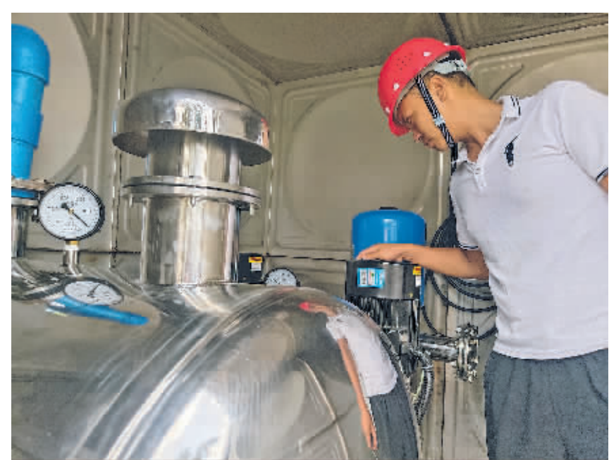
施工人员在查看金旗村供水管网二次加压泵房设备。
