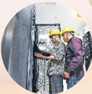
技术人员在全国一体化算力网络国家(贵州)枢纽节点主算力基地机房内进行相关测试。
