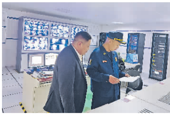
贵州物业管理服务有限公司开展消防检查。乌当区消防救援大队消防监督员在保利乌当区消防救援大队。
