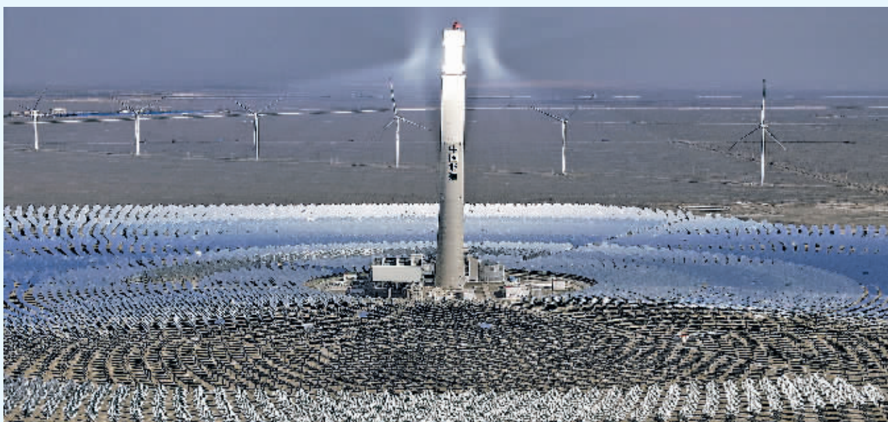
2024年9月12日在新疆哈密市伊吾县淖毛湖镇拍摄的国家光热示范项目——熔盐塔式50兆瓦光热发电站(无人机照片)。
