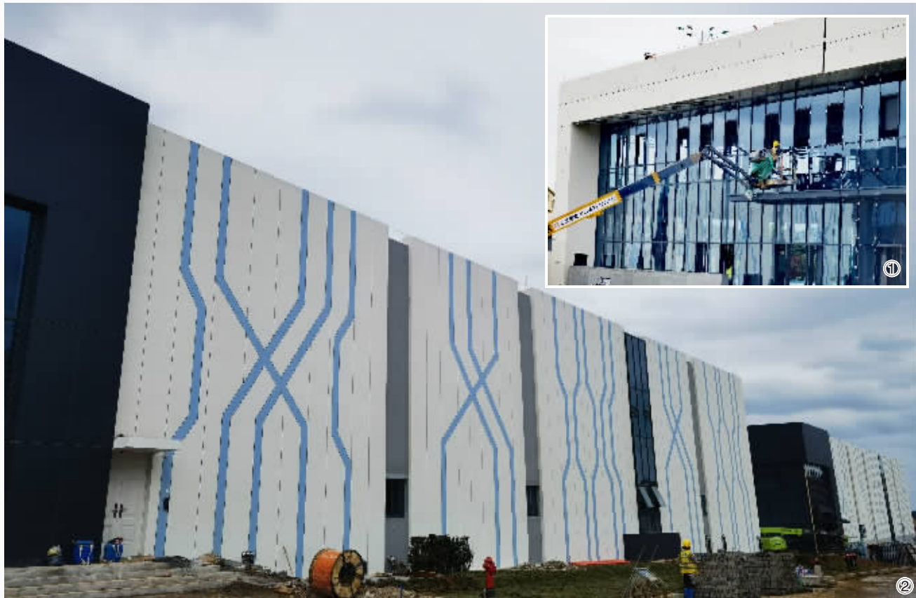
图①:工人安装玻璃幕墙。图②:南方能源大数据中心一角。
