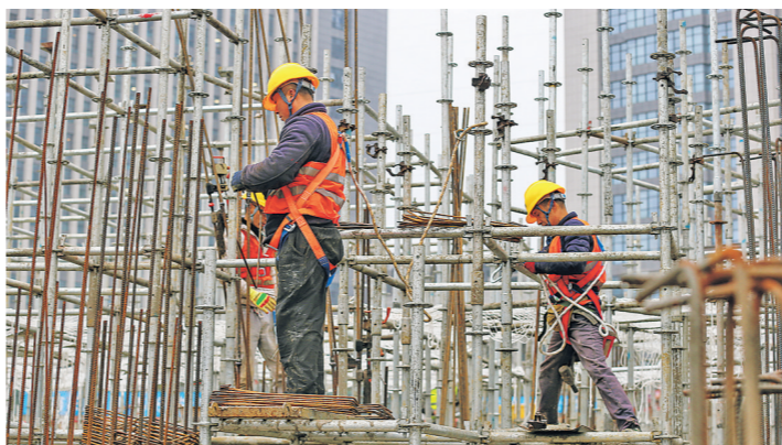
2月13日,工人在北京积水潭医院贵州医院二期项目施工现场忙碌。 贵阳日报融媒体中心记者 杨才江 摄
