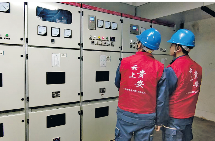
贵安供电局“云上贵安”党员服务队工作人员在检查高校电力设施。
