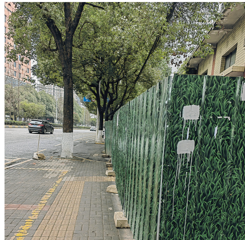
围挡占据了半个人行道。
