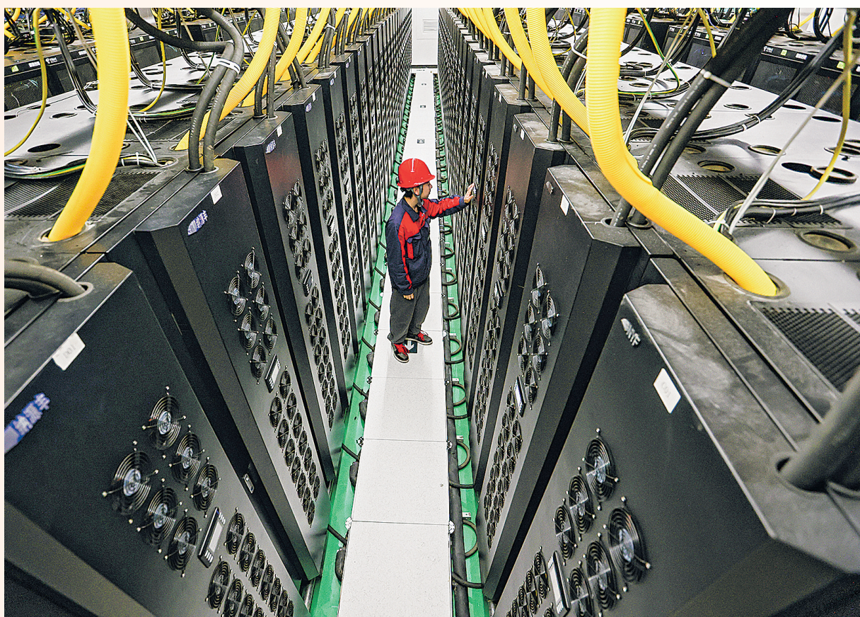
工作人员在考察贵视云计算中心数据机房巡检。贵阳日报融媒体记者 石强 摄
