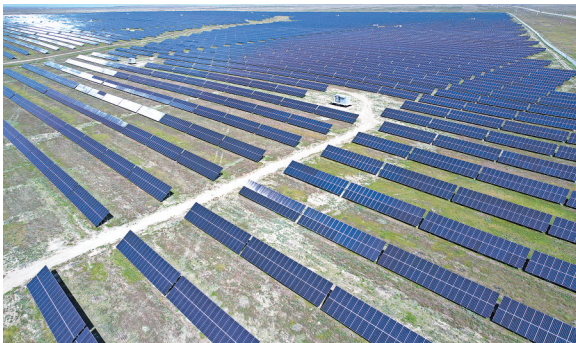
2023年5月4日在哈萨克斯坦阿拉木图州拍摄的卡普恰盖100兆瓦光伏电站的太阳能电池板(无人机照片)。
