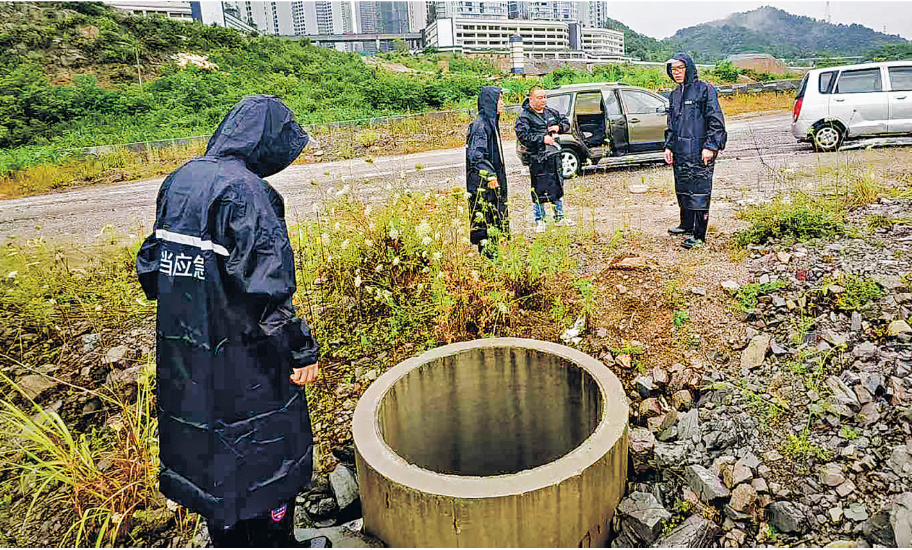
乌当区新光路街道巡查人员在排查中天·吾乡项目现场的安全隐患。
