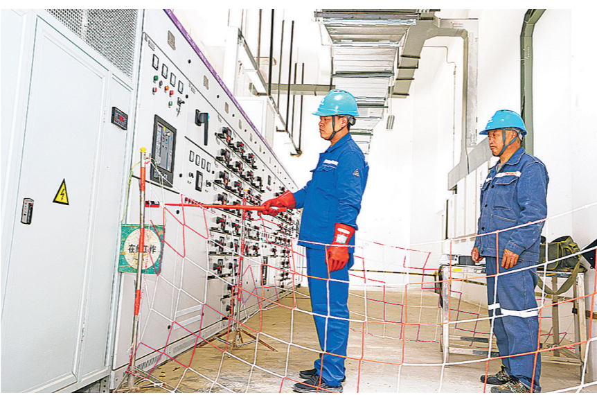
4月10日，工作人员在贵安综保区厂房内的配电室进行“一企一表”改造。 贵阳日报融媒体中心记者 石照昌 摄
