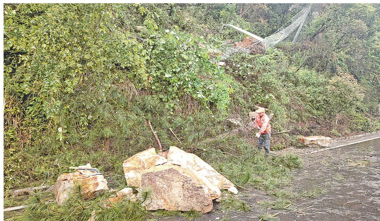
4月28日,道路养护人员在花溪区高坡乡石门村处置道路边坡塌方。 贵阳公路管理局/供图
