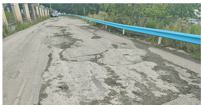
C411市级道路的一段路面坑洼难行。
