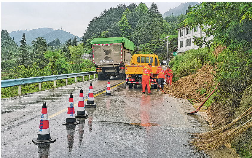
养护人员清理满防线(乌当区偏坡村新寨组)塌方道路。 贵阳公路管理局/供图
