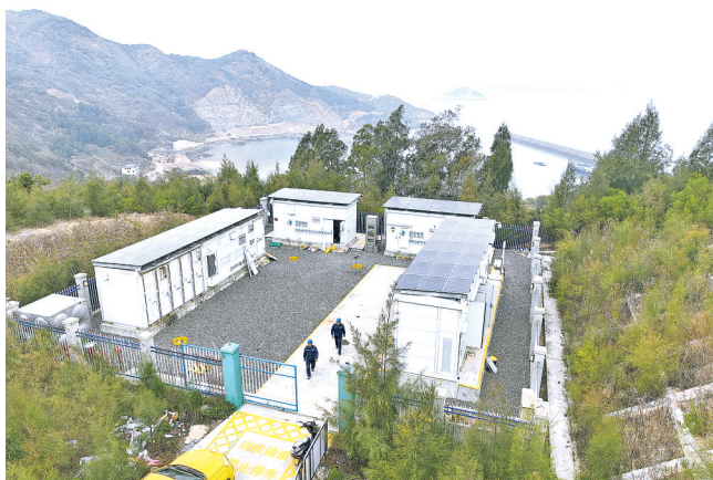
在福建省宁德市霞浦县海岛乡拍摄的微电网工程(2026年1月26日摄，无人机照片)。
